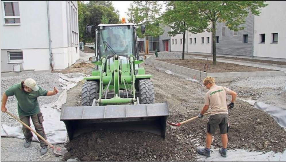
Mehr Platz, der besser zu nutzen ist: Neu gestaltet wird der Bereich zwischen den Schulen und den Sporthallen (rechts). Die Parkplätze fallen hier weg, 31 neue Stellplätze entstehen auf der Westseite der Turnhalle. Gittersteine sorgen zudem künftig dafür, dass die Rasenflächen besser begehbar sind und die Schüler bei Regen den Matsch nicht mehr ins Gebäude tragen. ■ Fotos: Heienbrok
